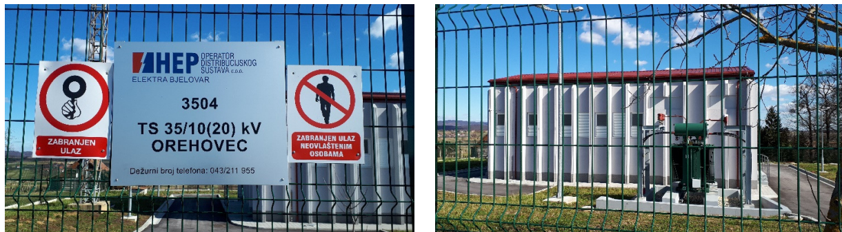
Slika 25.:Trafostanica TS 35/10(20) kV Orehovec
