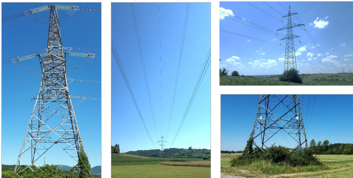
Slika 24.: Visokonaponski dalekovod 2x400 kV TS Žerjavinec - TS Heviz
