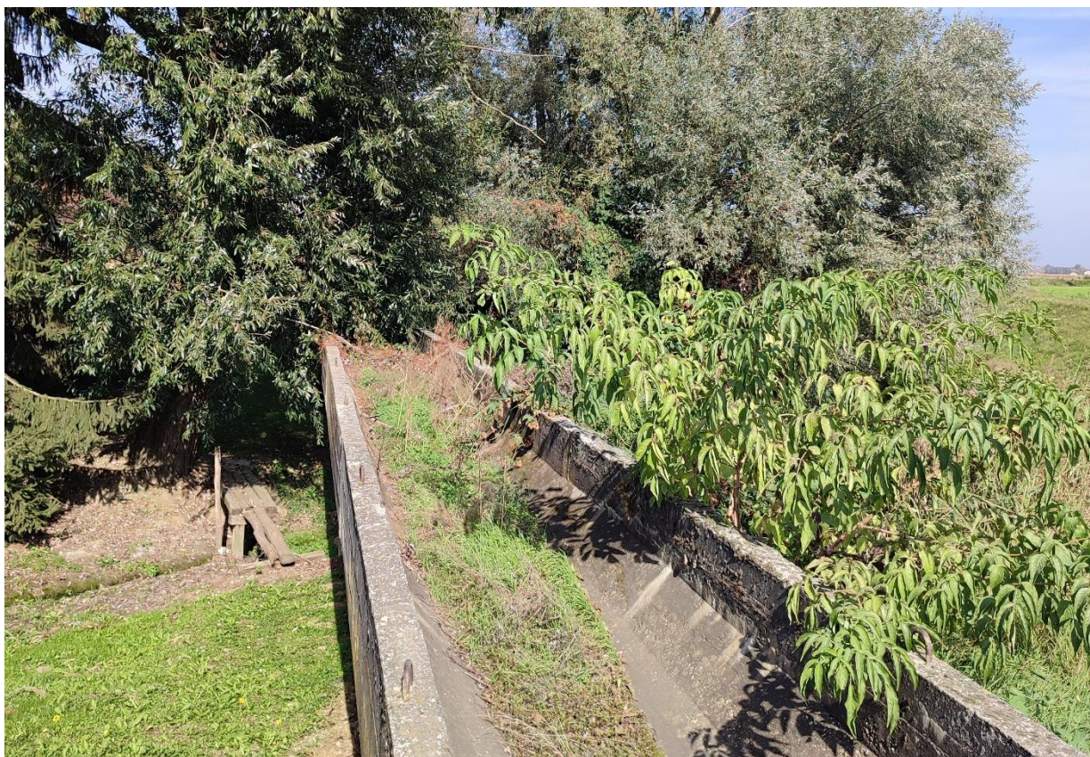
Sl. 1.2-12 Trenutno stanje odvodnog kanala za ribnjake (listopad 2023)
